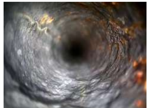
Corrosie aan de binnenzijde van de pijp
