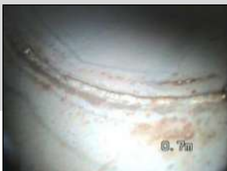
De lasnaden zijn aangetast door een substantiële aanwezigheid van corrosieve producten
