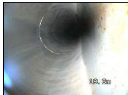
Uitgebreide roestplekken, zeer waarschijnlijk veroorzaakt door losse ijzerdeeltjes
