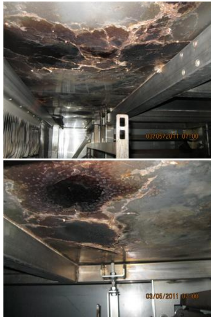
Interkristallijne corrosie bij een bakoven
